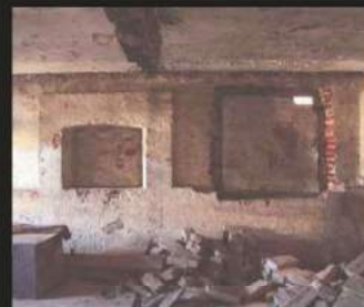
Pirma stāva telpa, kurā savākti kriegēļi no izbrukušajiem caurumiem.
