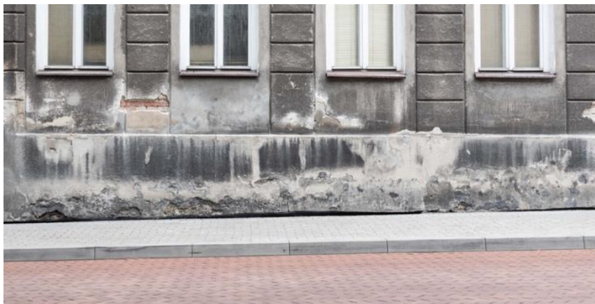
6.att. Grunts mitruma ietekme uz ēkas ārsienu
