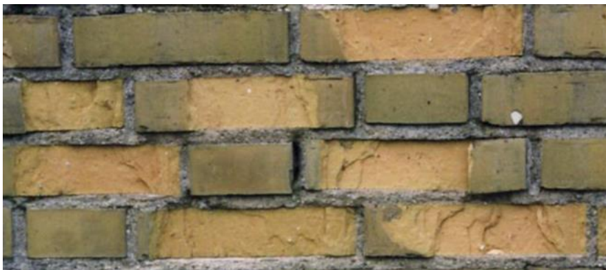
4.att. Sala radītie bojājumi
