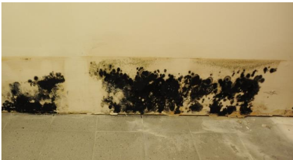
7.att. Pelējuma uz ēkas ārsienas iekšējās virsmas
